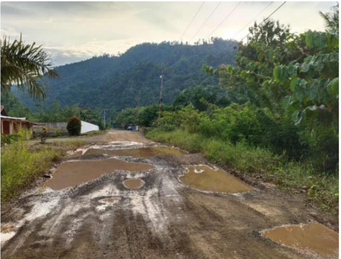
Tampak jalan poros Bimorjaya Mirip Kubangan Kerbau
